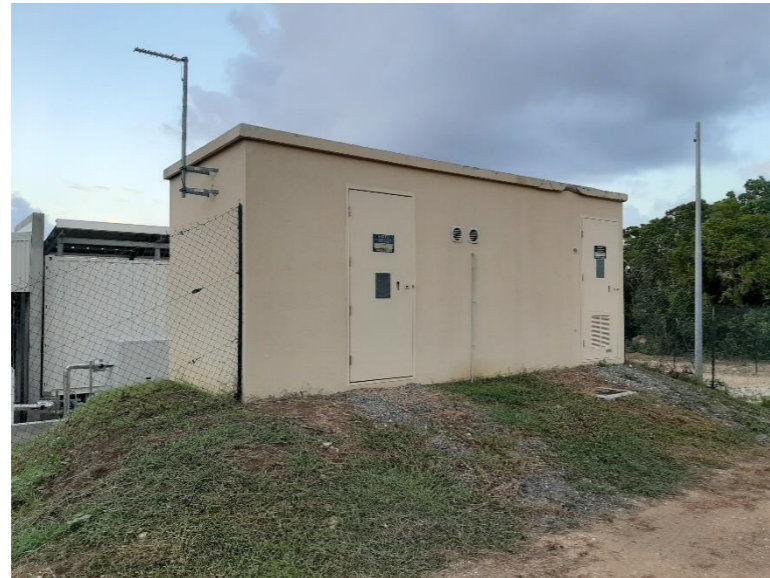
Figure 10 : Structure de livraison
