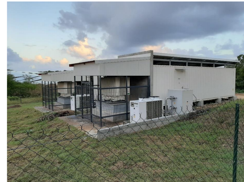
Figure 11 : Systèmes de stockage d'électricité et transformateurs associés
